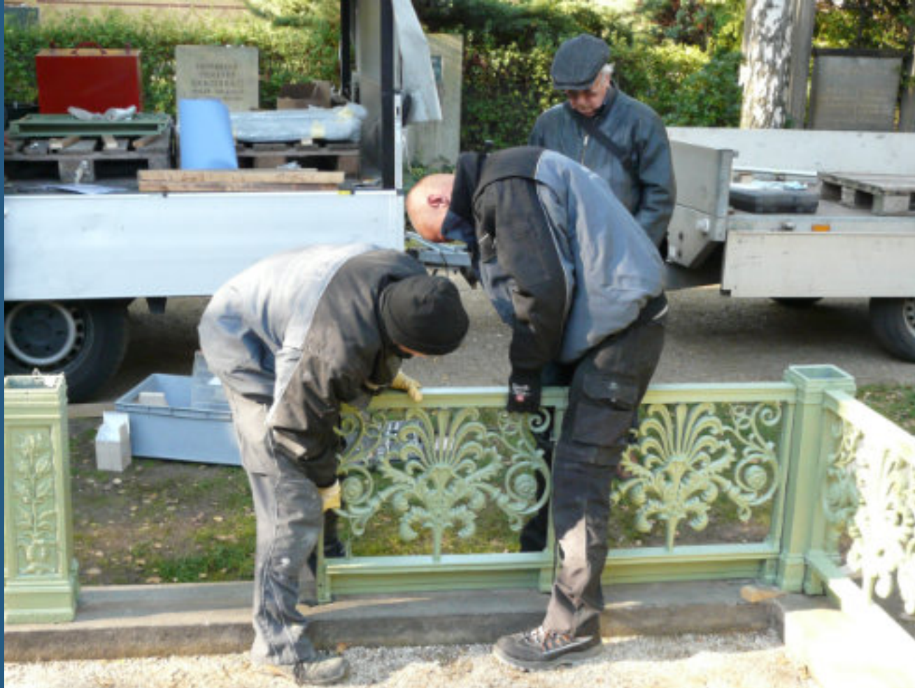
Abb. 80: Montage nach Positionsplan mit Stiftung und Schrauben aus Edelstahl Die „Füße“ wurden im Granitsockel mit Blei verstemmt
